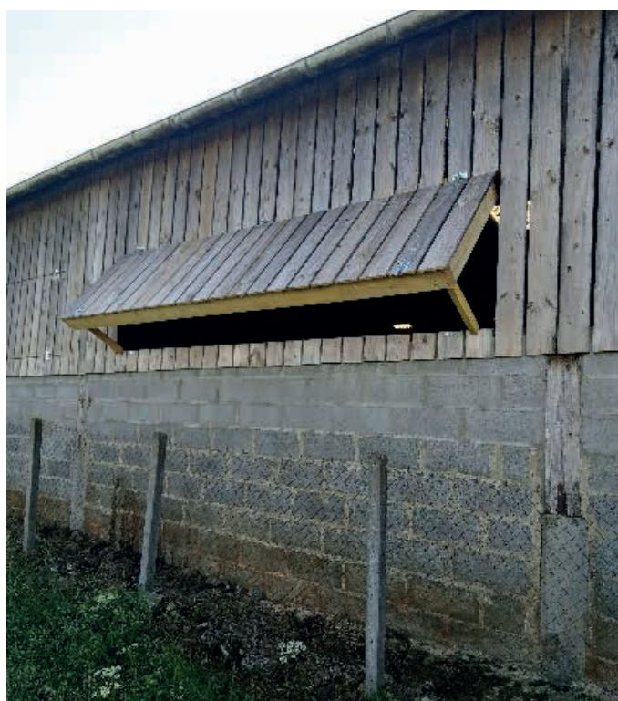
Photo 8 trappe protégeant du rayonnement (Crédit photo : Idele)
